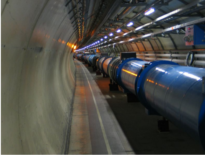
Slika 6. Odsek tunela s trkalnikom LHC. V notranjosti valjastih magnetov sta dve vakuumizirani cevi, po katerih v nasprotnih smereh krožijo protoni. Magnete od zunaj hladijo s tekočim helijem, hladilni sistem pa obdaja še izolacija (evakuiran sloj), ki preprečuje pritekanje toplote iz okolice.
